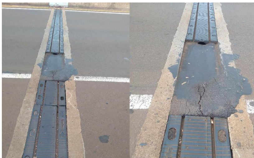
Ilustración 1 - Paño roto en Junta de Puente
