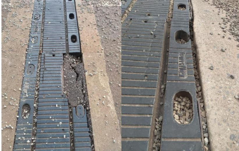
Ilustración 2 - Estado de Juntas
