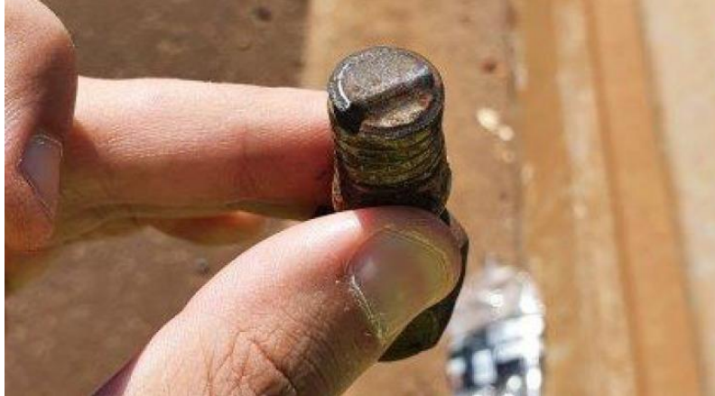
Ilustración 5 - Zona de falla de tornillo de sujeción
